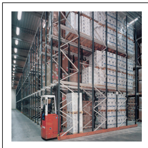
Figura 23 – Carrello elevatore alle prese con la movimentazione di carichi posti in profondità all'interno di scaffalature drive-in .
