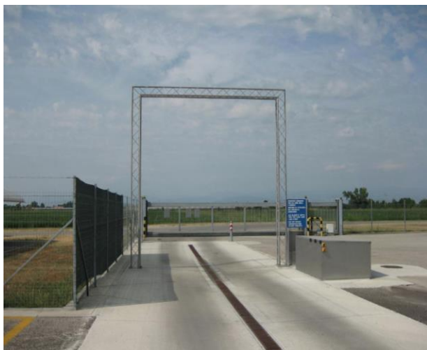
Figura 13. Arco di disinfezione in prossimità all'accesso dell'allevamento (A. Ioannoni & A. di Luca, 2021).
