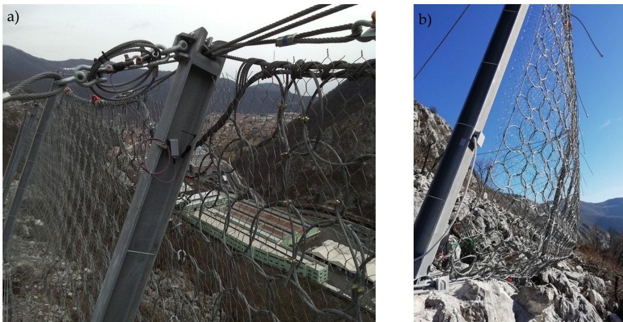
Figura 4.4 a) I moduli BPM sono stati disposti sui montanti ad un'altezza di 6.50 metri dalla base di fondazione e collegati alla cella di carico b) I dispositivi Trigger Link, sono stati disposti sui montanti di estremità prossimi alla centralina di acquisizione.
