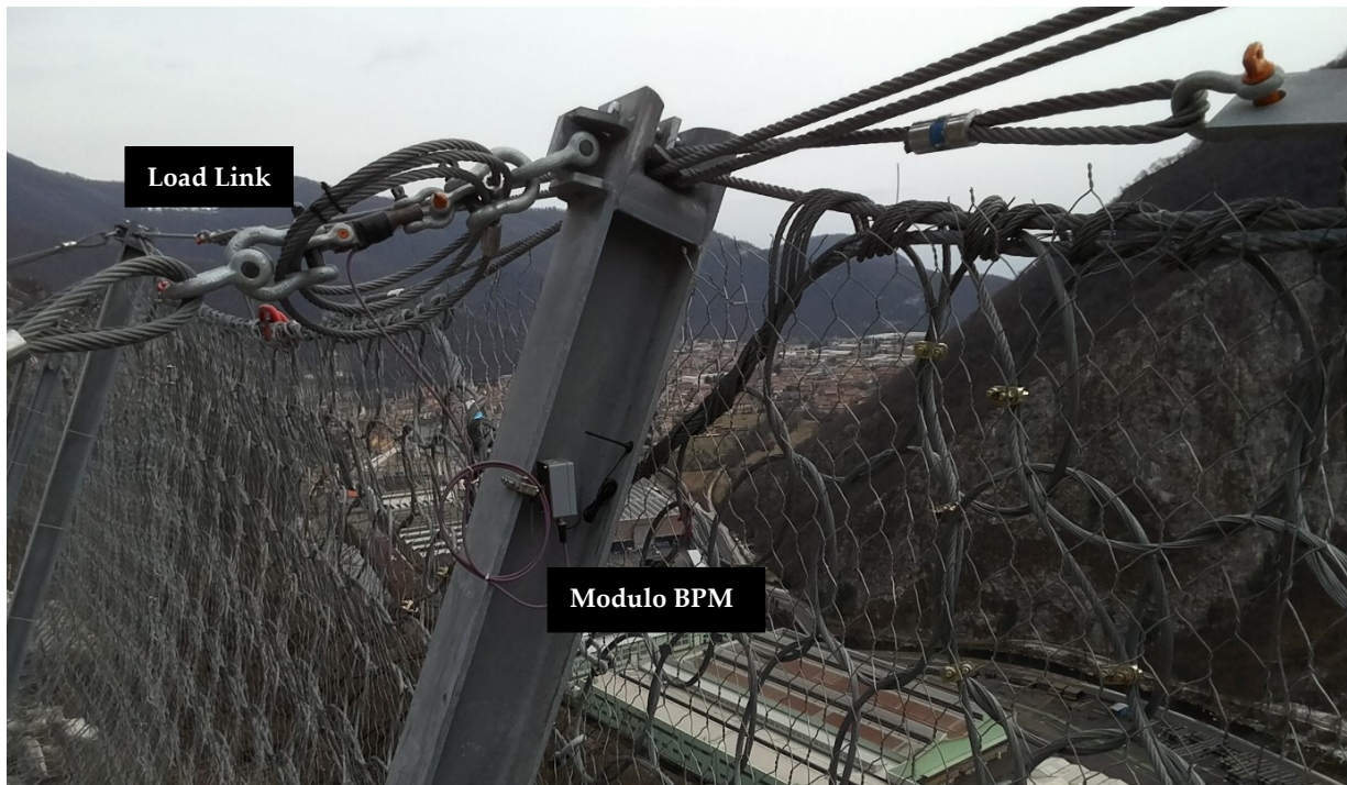
Figura 3.1 Monitoraggio di un montante mediante il sistema Rockfall Safety Network. I sensori RSN Link e RSN Link HR sono posti all'interno di uno scatolare contenente la batteria di alimentazione e la periferica di comunicazione radio. La cella di carico è installata tra il montante e i controventi di monte e viene collegata al modulo BPM mediante un cavo esterno.
