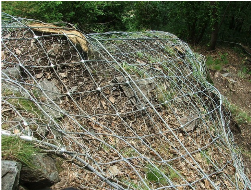
Figura 1.8 Esempio di rete in aderenza costituita da un duplice strato di rete a doppia torsione e pannelli in fune.
