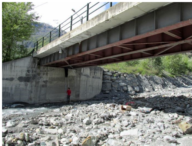
Figura 2.16 Installazione di un sensore a ultrasuoni.
