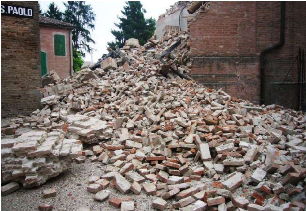
Figura 27: Disgregazione del paramento murario in seguito al sisma 2012.
