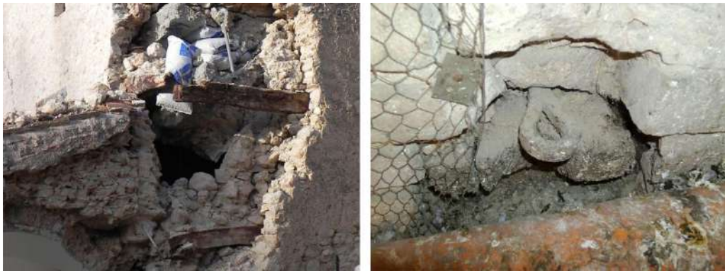
Figura 30: A sinistra, trave-radice che ha perso il collegamento all'angolo; a destra, catena con paletto mancante.
