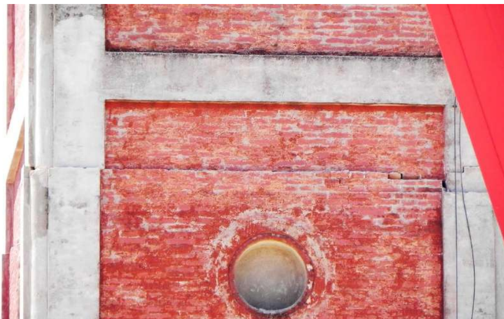
Figura 35: La lesione orizzontale nel basamento del campanile di San Martino in località Buonacompra a Cento (FE) denota la parzializzazione della sezione. A causa della gravità del danno il campanile è stato demolito.
