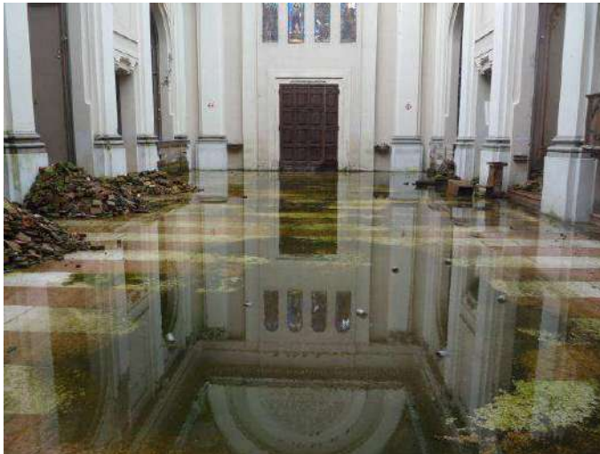
Figura 6: Interno della Chiesa di Sant'Egidio Abate a Cavezzo (MO). La mancanza della copertura per due anni ha inoltre esposto l'interno della chiesa agli agenti atmosferici e alla presenza di piccioni contribuendo ad un deterioramento progressivo delle finiture interne già gravemente danneggiate dal sisma.
