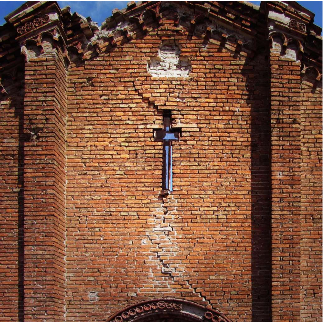
Chiesa di San Francesco d'Assisi a Mirandola (MO) danneggiata in facciata dal sisma del 2012.
