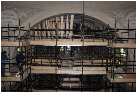
Figura 2: Presidio di sicurezza in tubi e giunti all'interno della Chiesa di Santa Maria Assunta (RE). L'opera è stata successivamente utilizzata come supporto per eseguire le lavorazioni di ripristino.
