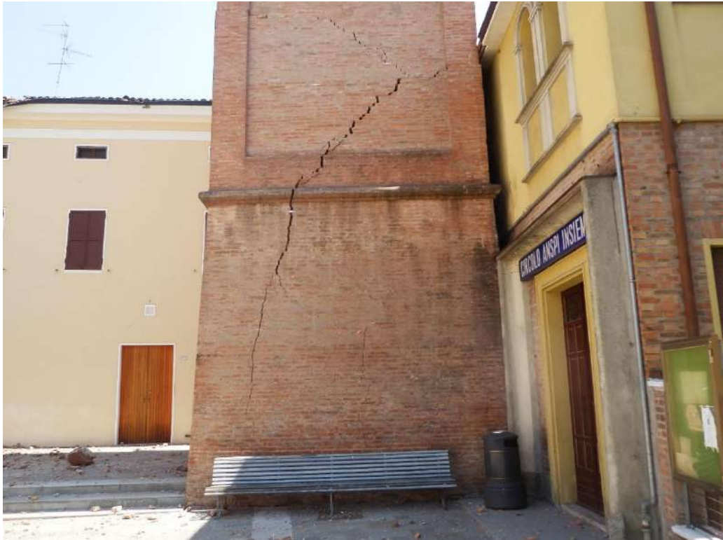
Figura 34: Dissesto dovuto a fenomeni di martellamento tra la torre campanaria della Chiesa di Sant'Egidio Abate a Cavezzo (MO) e l'adiacente fabbricato. Le lesioni si diramano a partire dal punto di contatto tra le due strutture.
