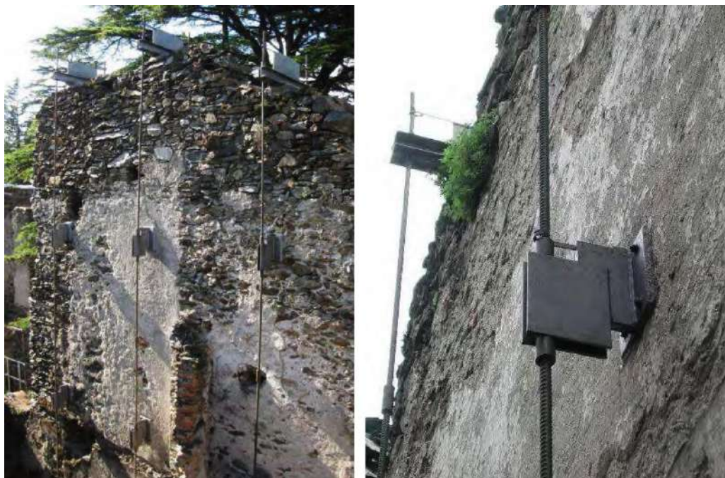
Figura 15: Sistema di consolidamento ETH nel forte di Fuentes a Colico (LC). (Jurina, 2013)
