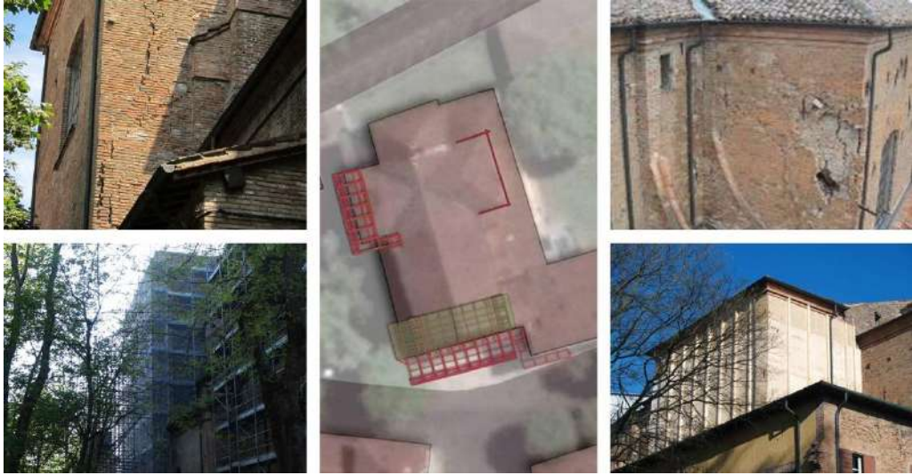
Figura 41: Chiesa del Gesù a Mirandola (MO). Diverse tipologie di dissesto e tecniche di messa in sicurezza nel transetto sinistro (a sinistra) e in quello destro (a destra).
