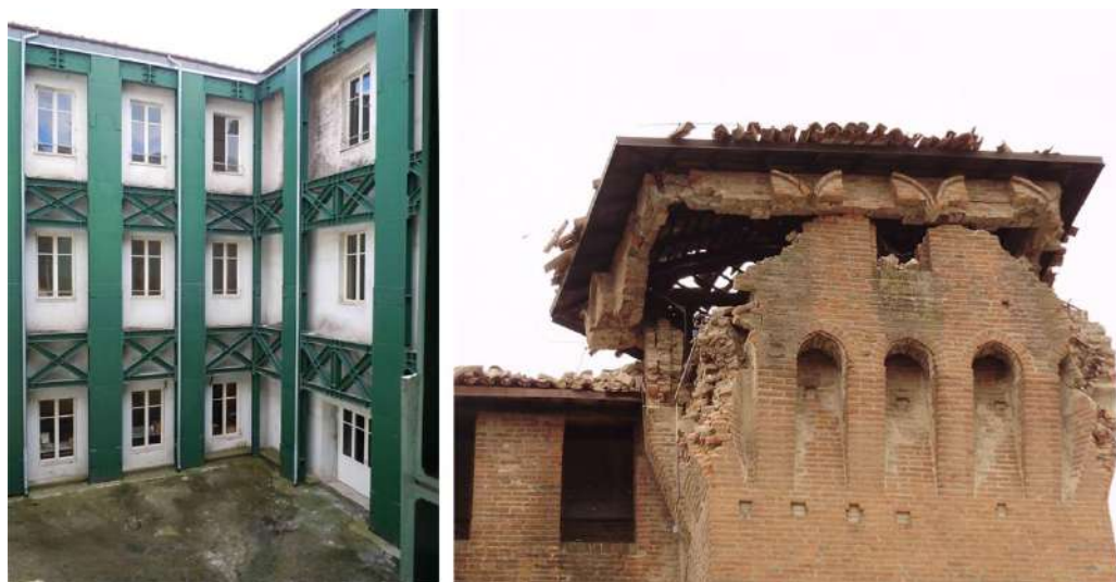
Figura 9: A sinistra, esempio di controventi a vista in un convento seicentesco; a destra, dissesti nella parte sommitale della torre angolare della Rocca Estense di San Felice sul Panaro (MO) causati, in occasione del sisma 2012, dalla presenza di un cordolo in c.a. inserito nel restauro degli anni '70.
