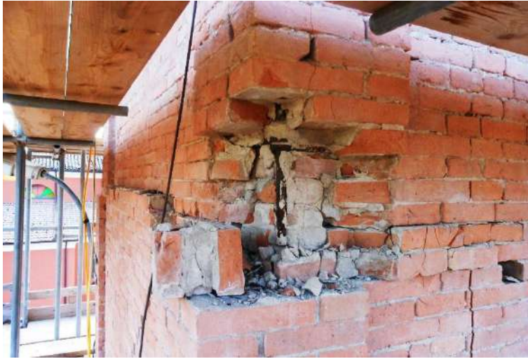
Figura 21: Il capochiave incassato nella muratura del campanile di Sant'Anna a Reno Centese (FE) è stato punto di innesco delle lesioni che hanno interessato la torre in occasione del sisma 2012.
