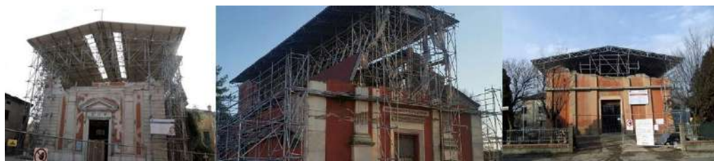
Figura 1: Copertura provvisoria nella Chiesa di San Felice Vescovo e Martire a San Felice su Panaro (MO), Chiesa di San Martino di Tours a Buonacompra di Cento (FE) e Chiesa di San Bartolomeo Apostolo a Villafranca di Medolla (MO)
