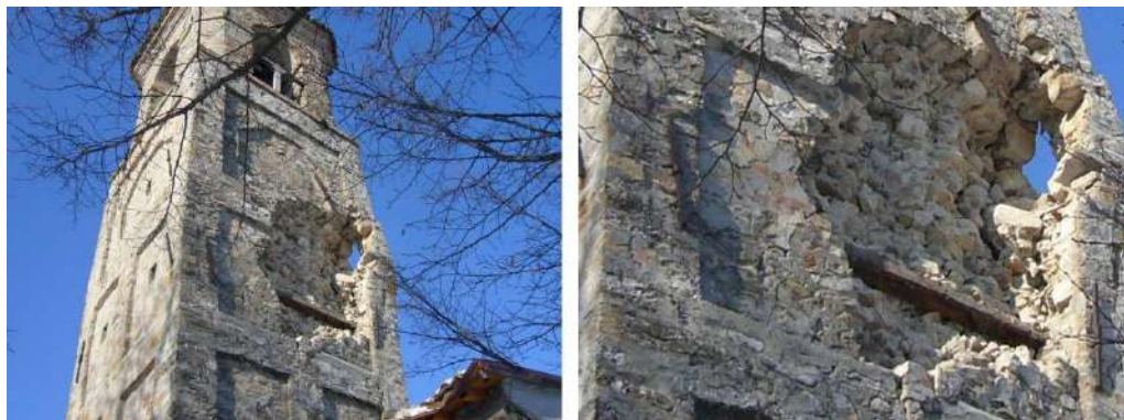
Figura 33: Campanile dell'appennino parmense danneggiato dal sisma del 2008. Dissesto dell'angolo dovuto a instabilità per carico di punta.
