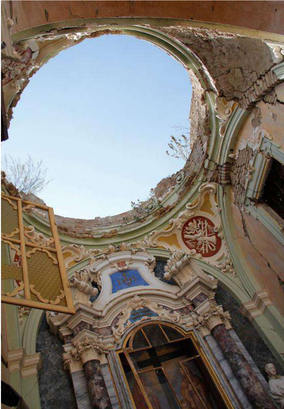
Figura 28: crollo della cupola nella Chiesa di San Felice Vescovo a San Felice sul Panaro (MO).
