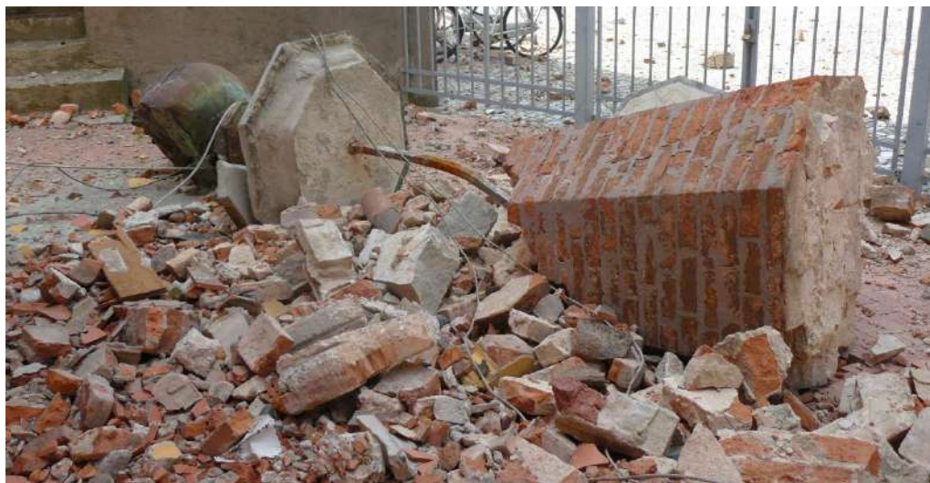
Figura 37: Sommità in muratura della guglia del campanile di Sant'Agostino (FE) crollata a terra senza disgregarsi.
