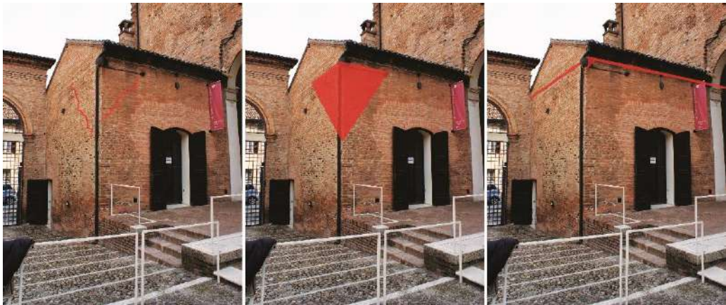
Figura 10: Angolo della biglietteria di Palazzo Costabili a Ferrara. Le lesioni inclinate in corrispondenza dell'angolo (a sinistra) denunciano l'attivazione di un meccanismo di ribaltamento composto fuori dal piano (al centro). L'inserimento di una cerchiatura esterna ne impedisce il collasso e allo stesso tempo permette di ridurre l'impatto visivo degli impianti in facciata (a destra).
