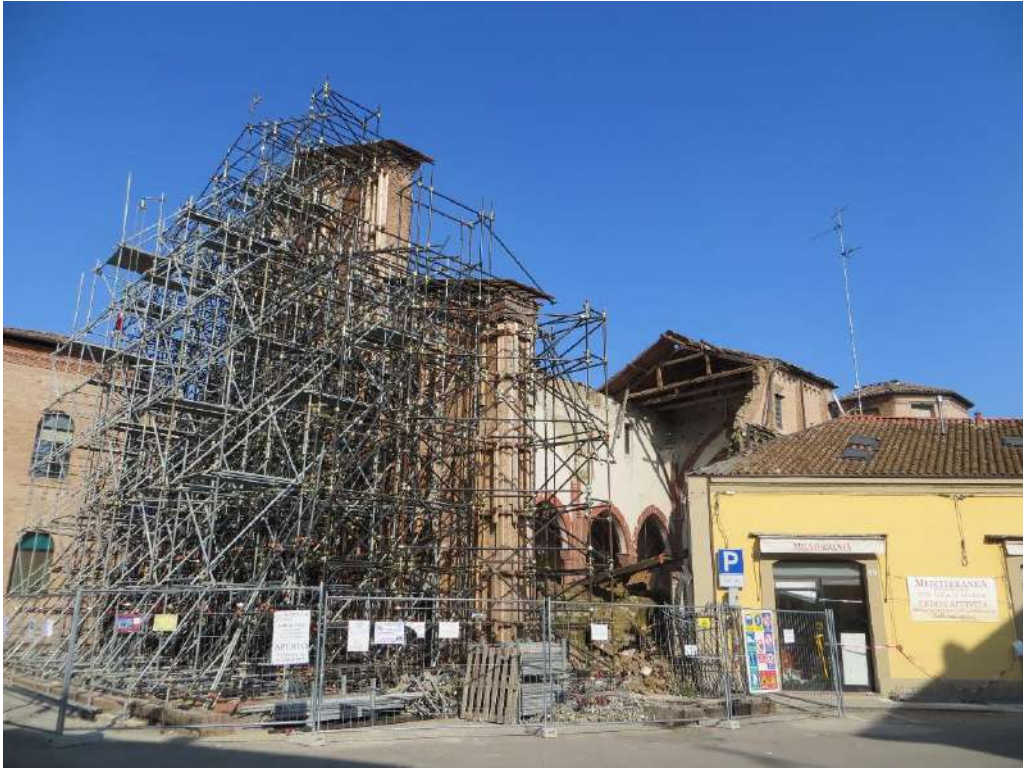
Figura 11: Il puntellamento della facciata di San Francesco a Mirandola (MO) è stata una delle prime messe in sicurezza realizzate dai Vigili del Fuoco.
