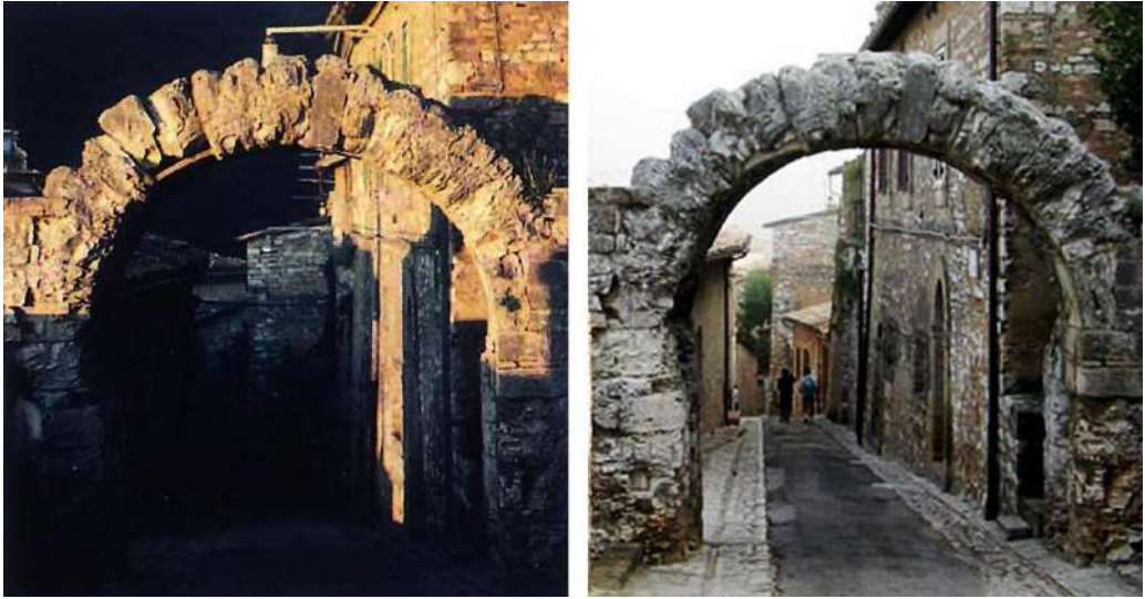
Figura 6: Arco di Spello, Perugia. A sinistra, presidio metallico di sicurezza dell'arco dissestato; a destra intervento definitivo di risarcitura.
