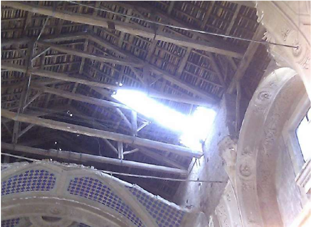
Figura 29: Crollo parziale nella copertura di una chiesa a Carpi. Il dissesto puntuale nel nodo di una capriata ha causato il cedimento della catena sulla sottostante volta in foglio.
