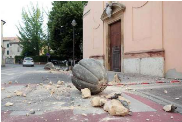
Figura 39: crollo sul sagrato della chiesa di un elemento decorativo posto in sommità della facciata.
