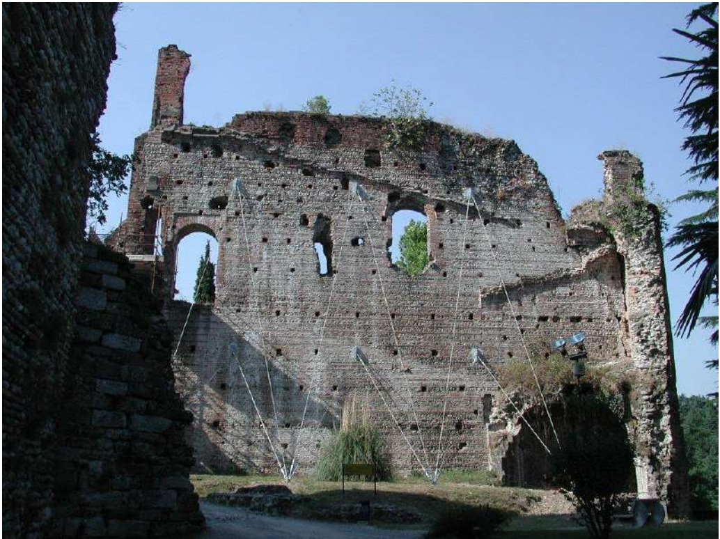
Figura 3: Muro isolato nel castello di Trezzo sull'Adda, consolidato con stralli in acciaio.
