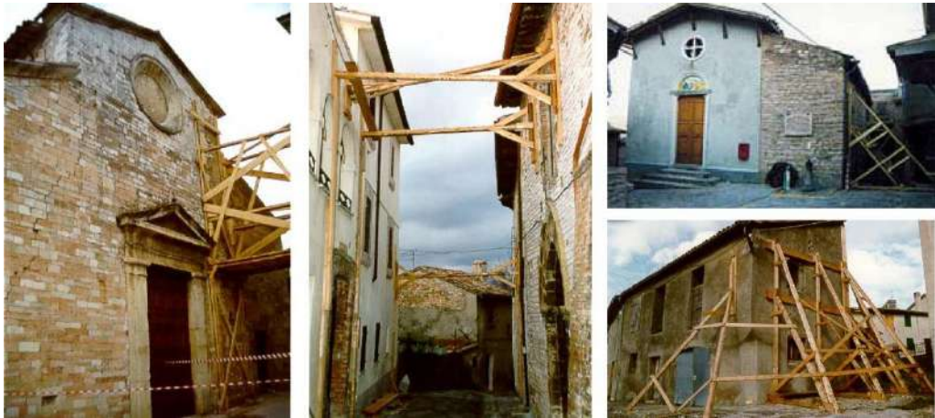
Figura 5: Opere provvisorie realizzate nel terremoto del 1997 in Umbria e Marche - Immagini tratte da (Dolce, et al., 2004, p. 1-2)
