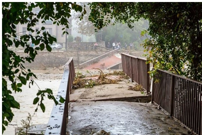
Figura 4.2: Crollo del ponte storico della Navetta
