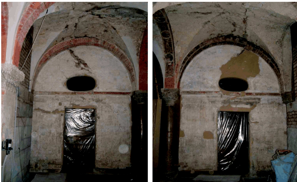
Figura 4.13: Le lesioni e deformazioni simmetriche sulle parti adiacenti ai piloni della parete occidentali della cripta, realizzate nel 1556.
