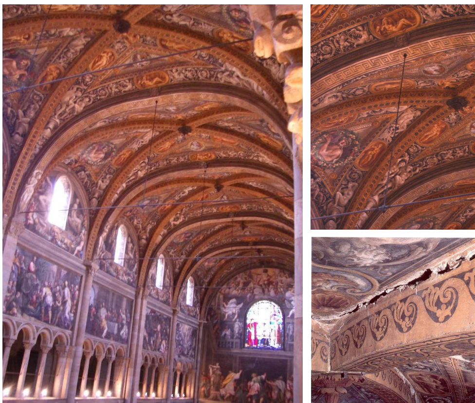
Figura 4.8: Le evidenti deformazioni delle volte della navata centrale: in basso a destra il distacco tra costolone e volta che si presentava nel 1989 ai restauratori [6].
