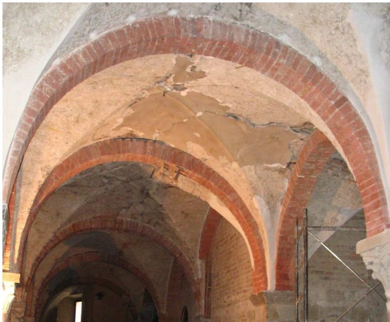
Figura 4.12: Il marcato quadro fessurativo delle volte a crociera della cripta.
