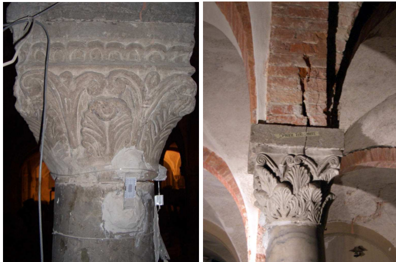
Figura 4.11: Le recenti lesioni in colonne e capitelli della cripta.
