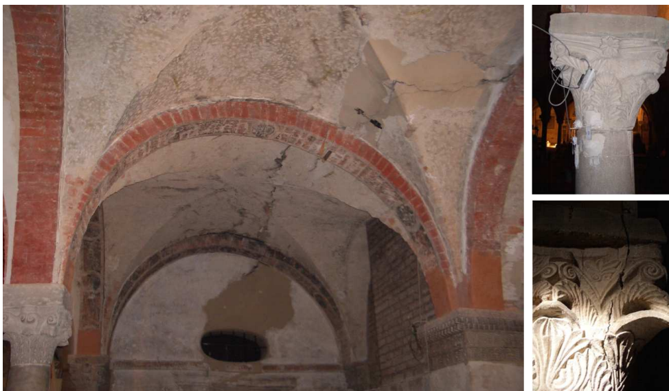
Figura 3.6: Gli effetti visibili dei cedimenti differenziali sulle strutture della cripta più vicine ai piloni di sostegno della cupola.
