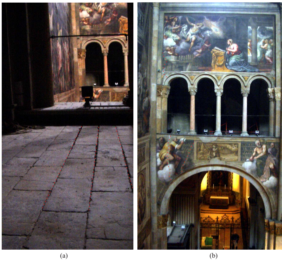
Figura 4.4: (a) L'avvallamento del pavimento dei matronei testimonia il meccanismo di rotazione della facciata. (b) La rotazione della facciata coinvolge anche parte delle murature longitudinali.
