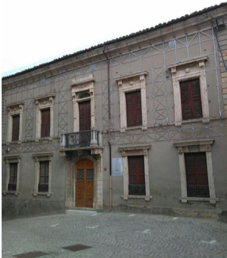
Figura 14 Comune di Force: il paese è completamente disabitato e tutte le strutture hanno supporti esterni ed interni [febbraio 2018].
