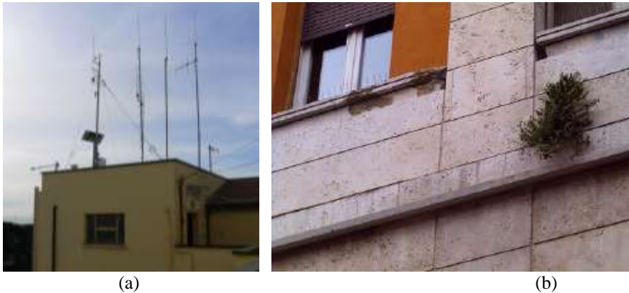
Figura 5.129 – (a) Antenne presenti sulla porzione piana della copertura; (b) degrado del rivestimento esterno.
