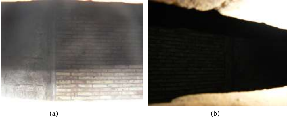
Figura 5.52 – Vista dell'interno della torre, dal "buco" ottenuto tramite prelievo del mattone M1.
