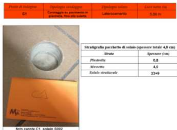
Figura 5.105 – Stratigrafia del pacchetto di solaio, come desunta dal microcarotaggio C1 all'estradosso del solaio di copertura del piano terra.
