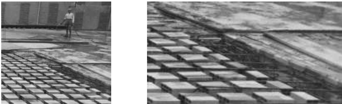
Figura 2.19 – Ingrandimento della zona d'interruzione del getto.
