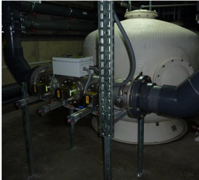
Figura 33: reattore installato sull'impianto di trattamento acqua
