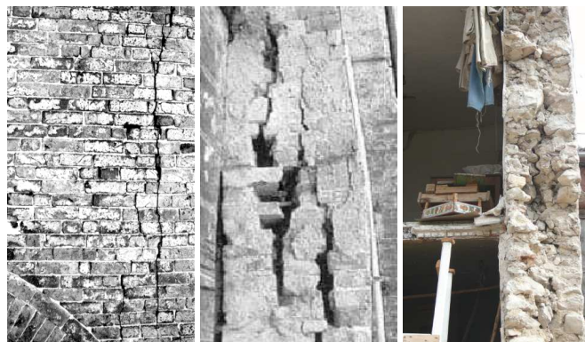
Figura 3.14- Alcuni esempi di lesioni causate da schiacciamenti della muratura.
