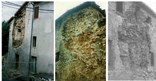
Figura 3.10- Esempi di disgregazione muraria.
