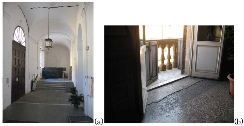
Figura 9.35 -Quadro fessurativo della facciata: (a) lesioni sulle volte del piano terra, (b) lesioni sul pavimento del primo piano.
