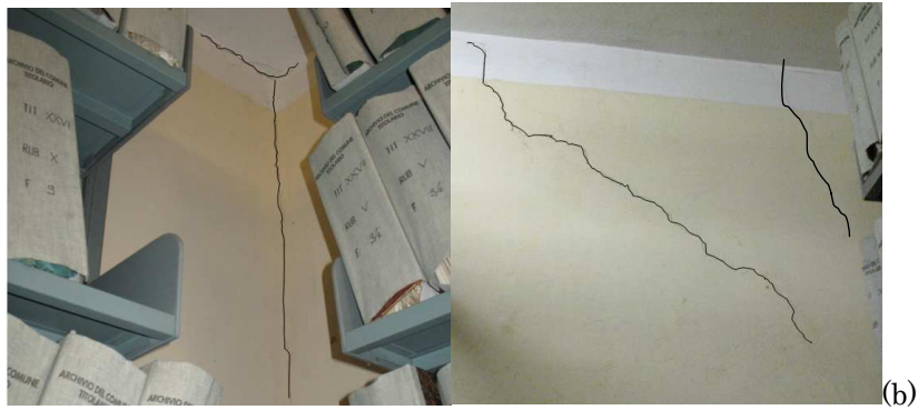
Figura 9.5 -Meccanismo di ribaltamento semplice di porzione di parete: (a) Localizzazione del meccanismo, (b) quadro fessurativo.
