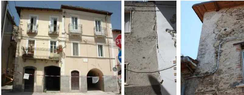
Figura 3.7- Fenomeni di martellamento in aggregati edilizi.
