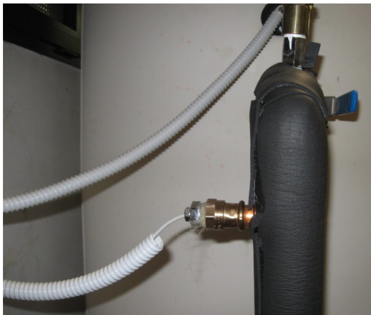
Figura 4.11 – Sonda di temperatura sulla tubazione di ritorno dai collettori solari.
