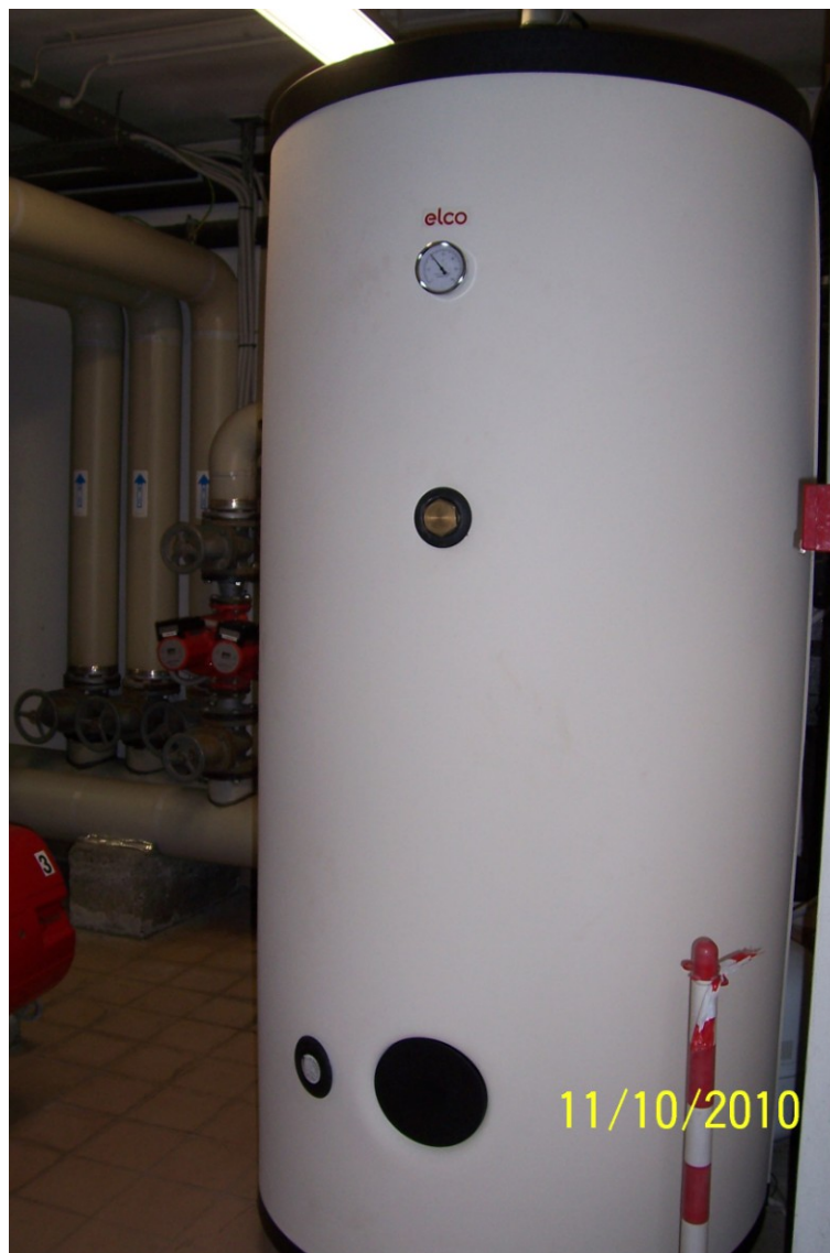
Figura 4.4 – Serbatoio di accumulo.
