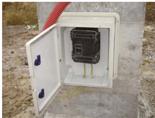
Fig.4.16-Centralina acquisizione dati piezometrici
