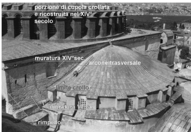
Figura 3.2.2. Foto del lato est del tamburo quadrato di Carlo Blasi. Nella muratura si vede chiaramente la traccia del crollo e la ricostruzione del muro del XIV secolo e le porzioni di cupola crollate e ricostruite.
