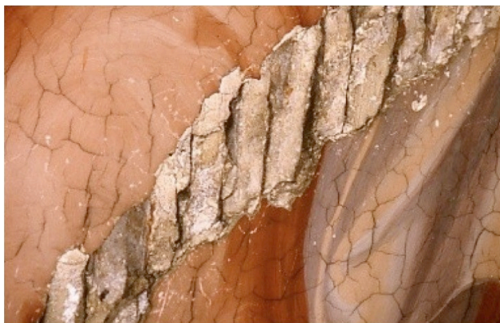
Figura 5.3.2. Le fessure nei mattoni per dritto della spinapesce
